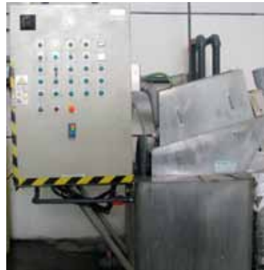
新設の油除去装置
