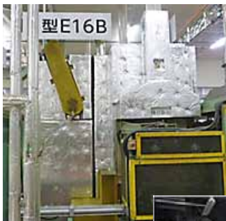
接着設備の断熱 (左)
